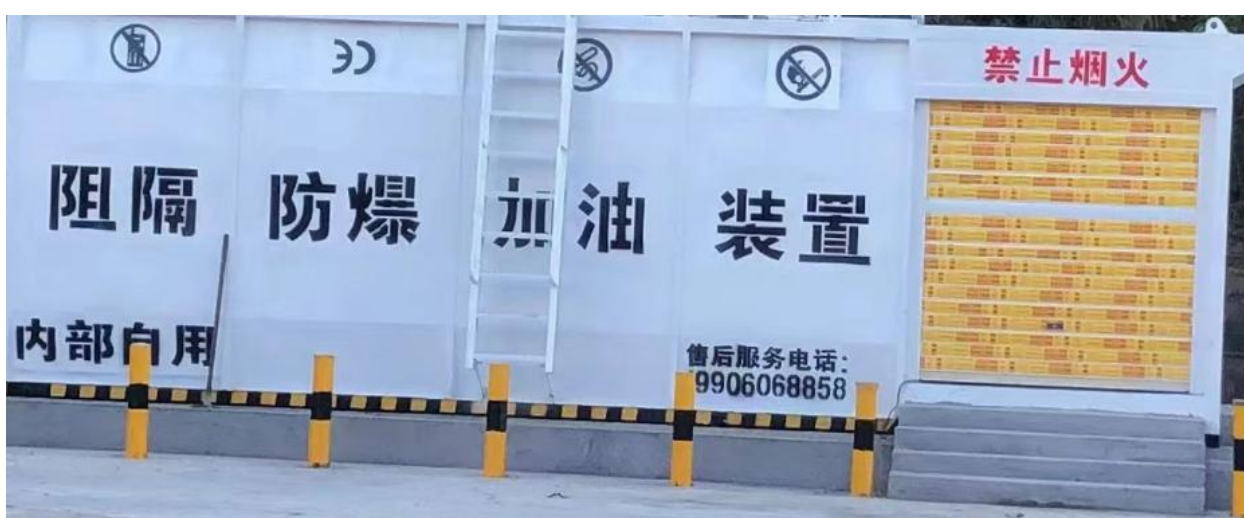
柴油储罐区及加油装置区
