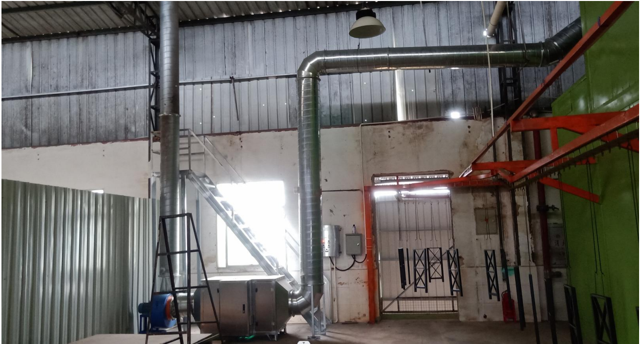
燃天然气烘干炉废气与固化废气处理设施（活性炭吸附装置+UV光解+15m高排气筒）
