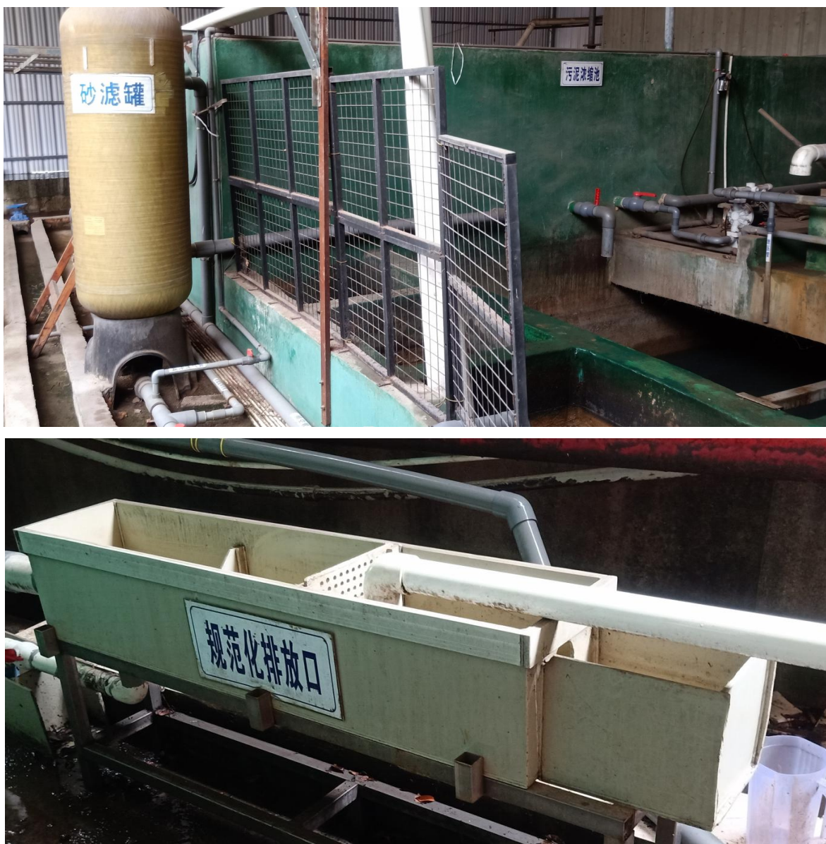
图 3.1-1 项目废水处理设施
