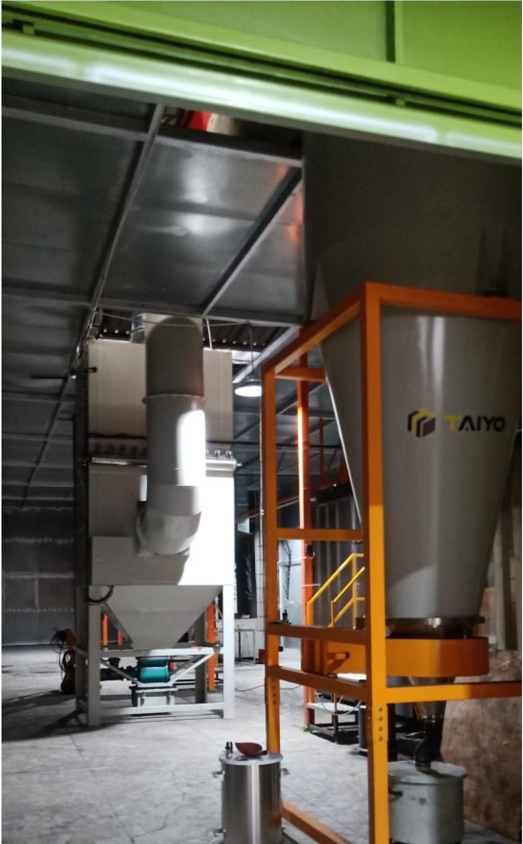
旋风除尘+布袋除尘装置 图 3.2-1 废气处理设施装置
