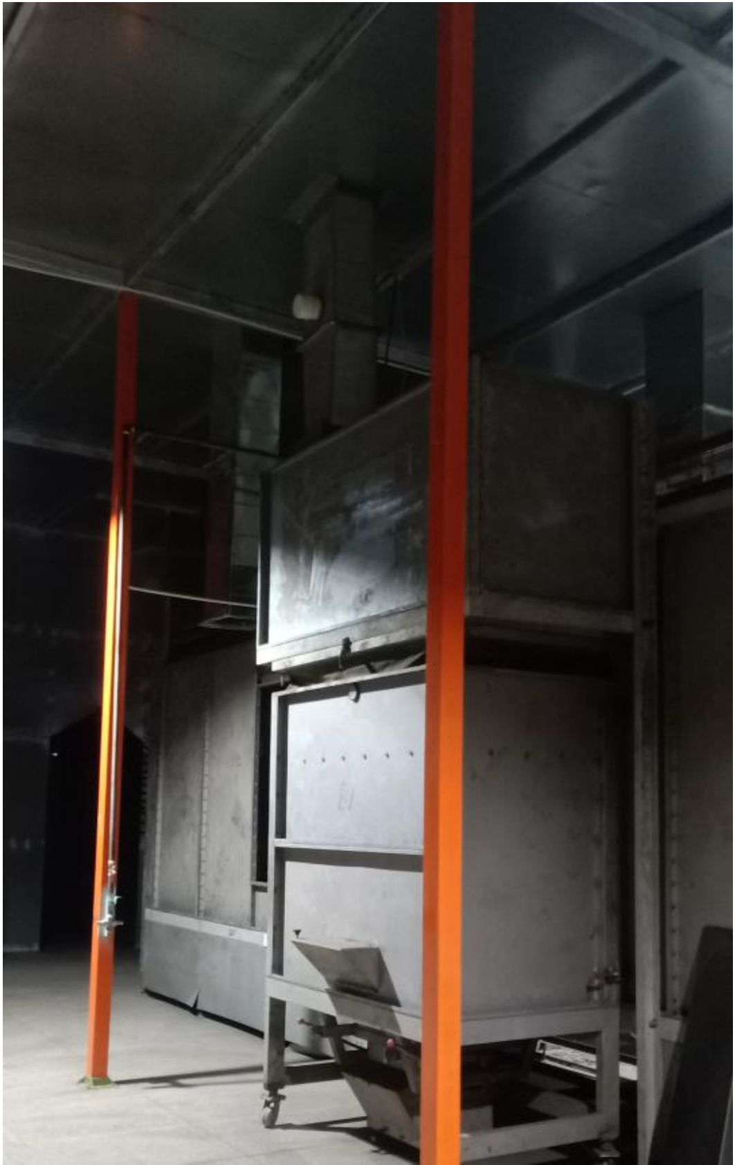
滤芯除尘装置
