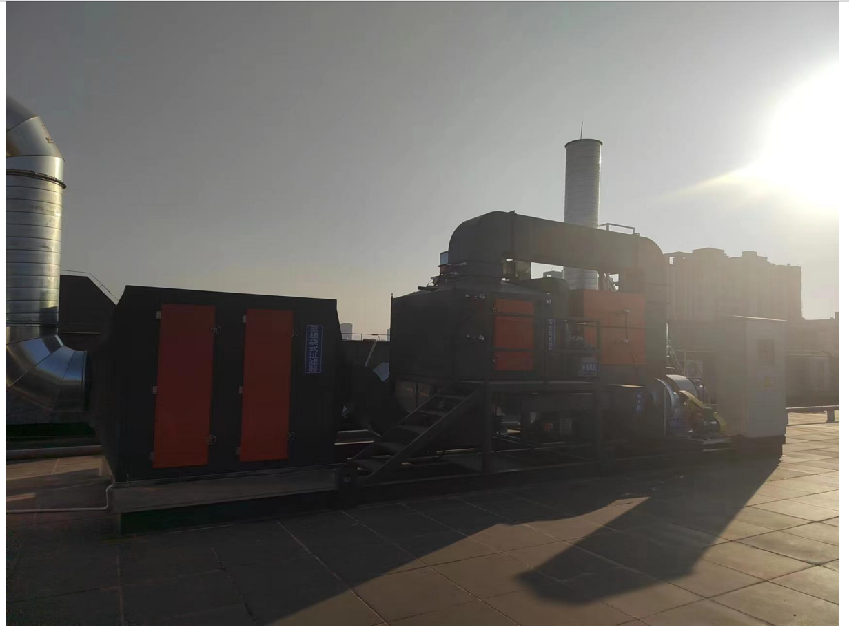
图 3-1 活性炭吸附+RCO处理设施及排气筒
