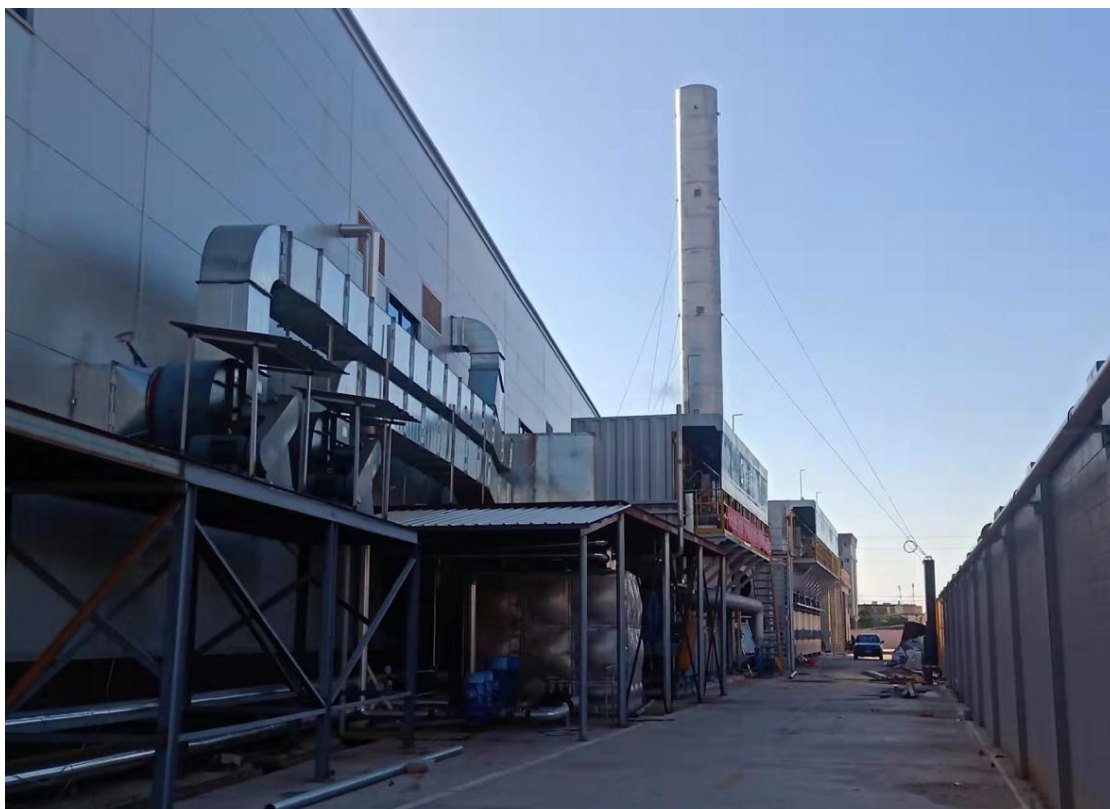
RTO 废气处理装置（床式蓄热式氧化炉）+余热回收处理+26m 高排气筒
