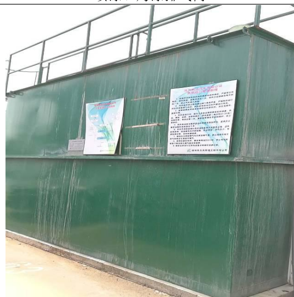
依托污水站照片
