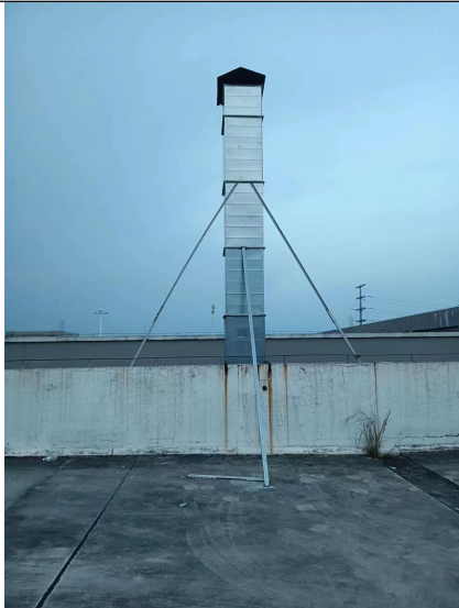
喷漆、烤漆排气筒
