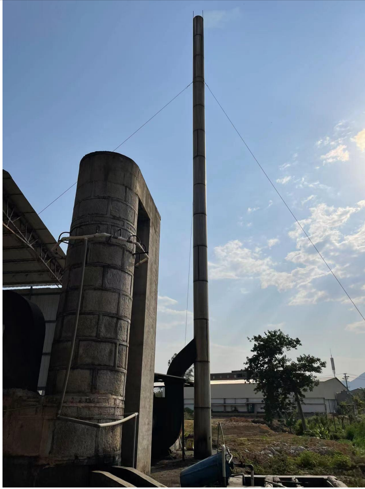
图 3-1 废气处理设施
