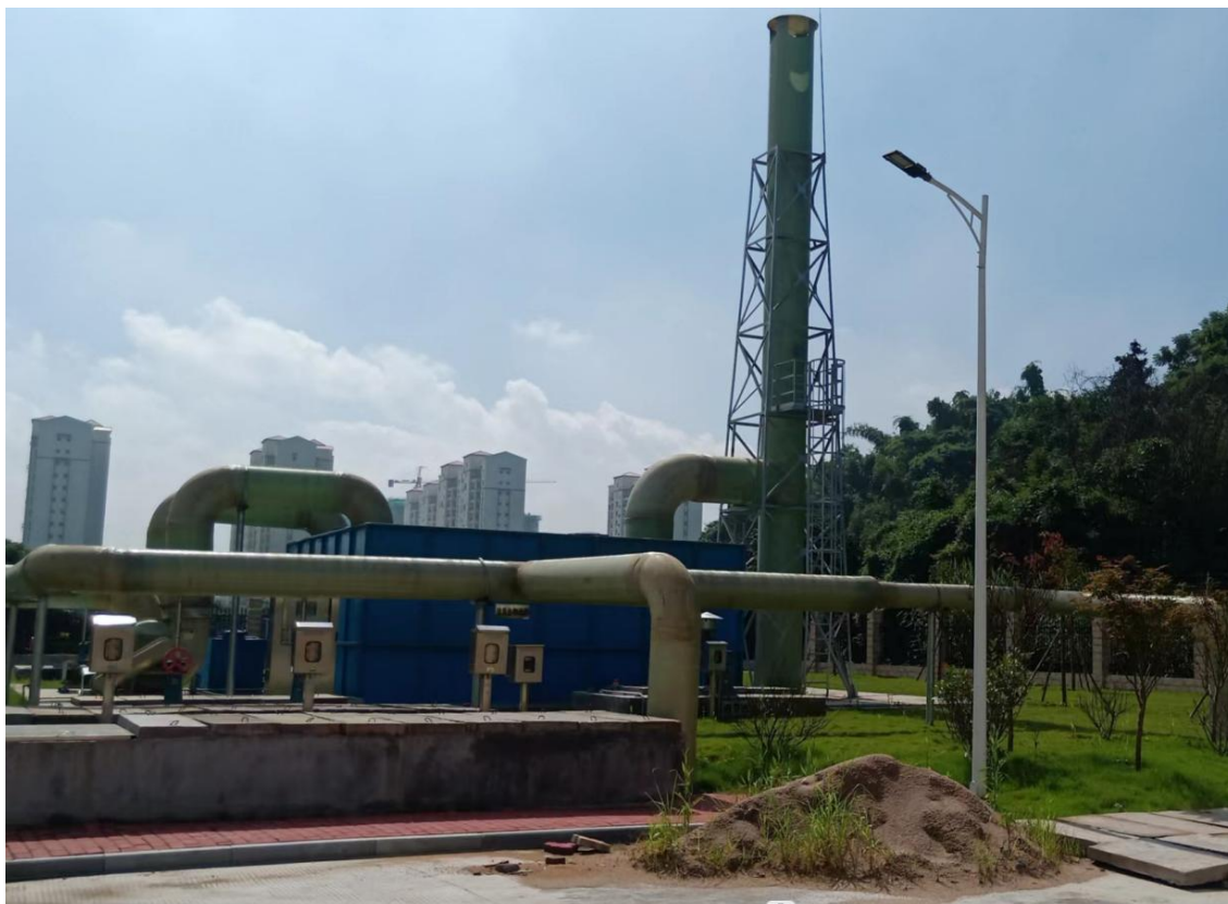
图 4-2 废气生物除臭系统装置+15m 高排气筒
