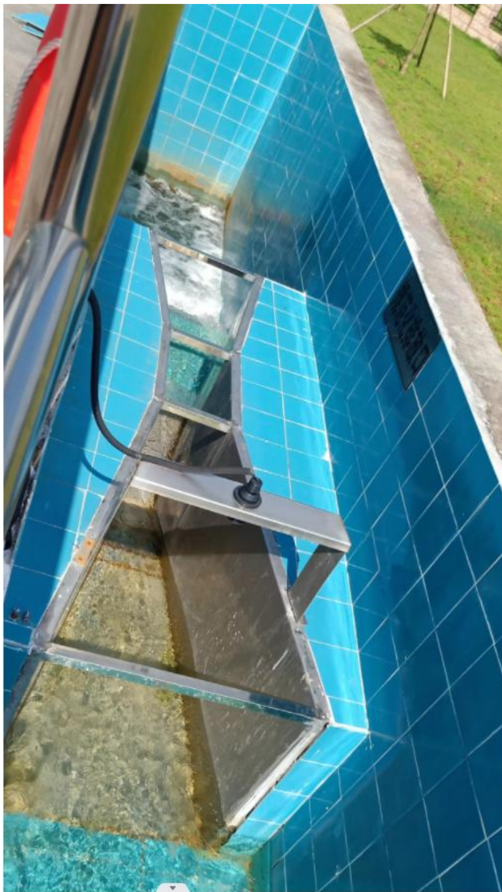
图 4-5 废水规范化排放口
