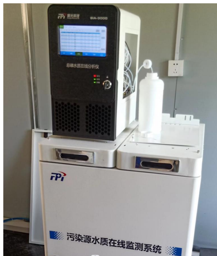
图 4-6 化学需氧量、氨氮、总磷在线监测系统
