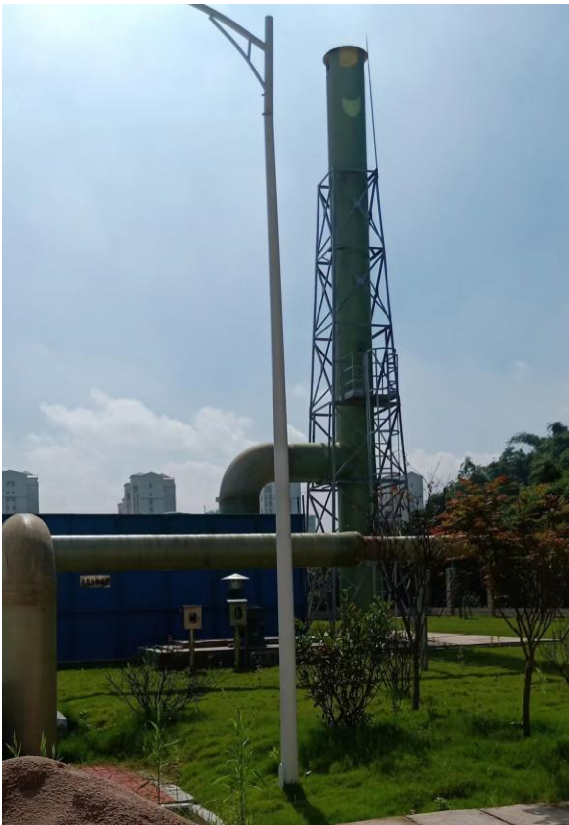
图 4-4 排气筒监测平台及通往监测平台通道、监测孔
