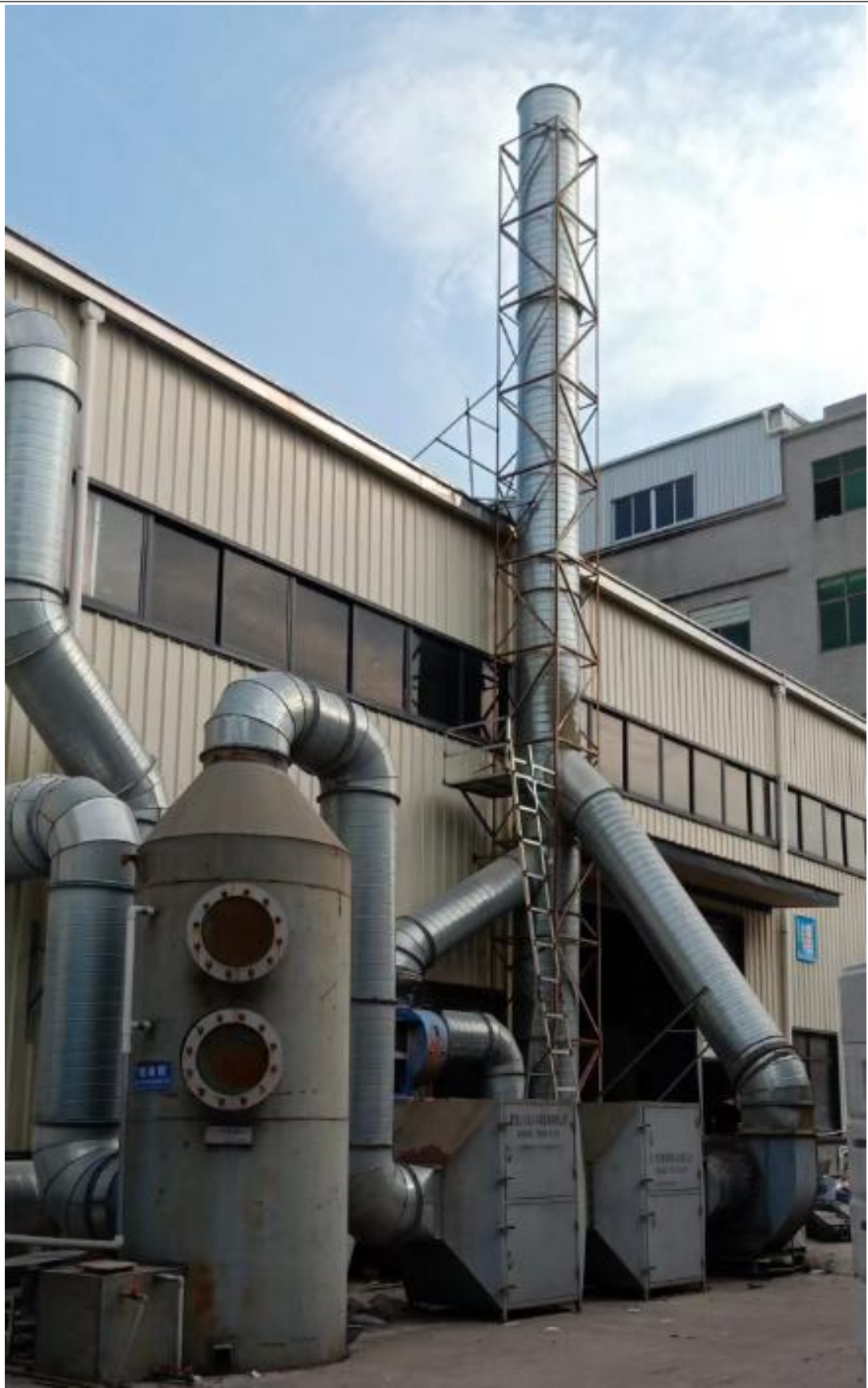
彩绘、喷漆废气处理设施（水喷淋塔+活性炭吸附装置+15m 排气筒）
