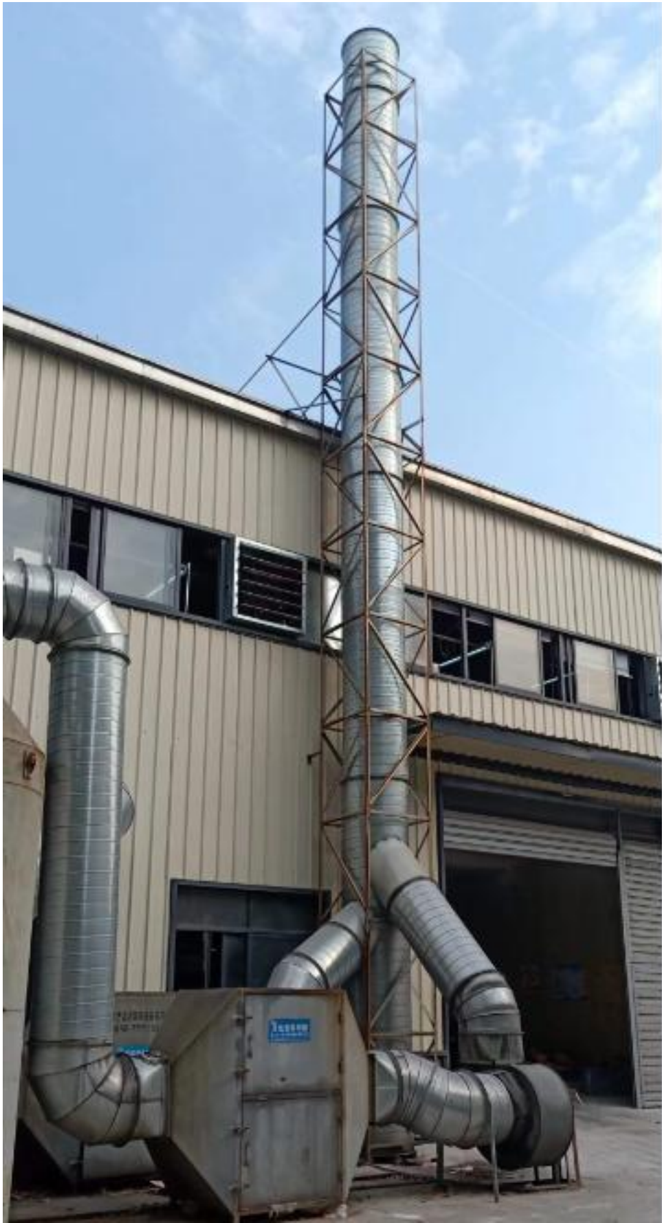
真空成型废气处理设施（水喷淋塔+活性炭吸附装置+15m 高排气筒）
