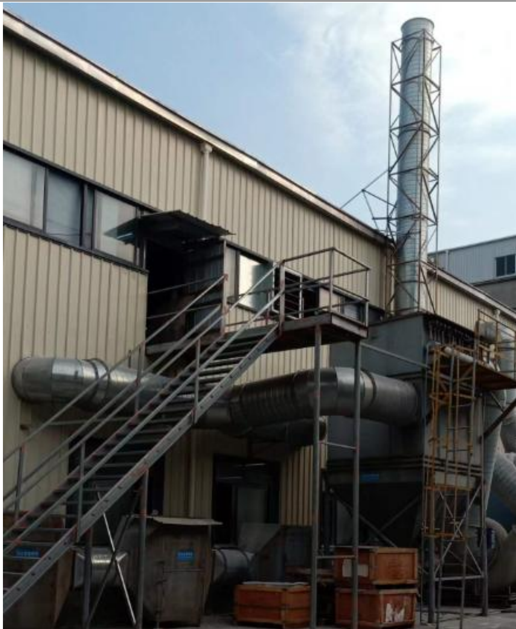
打磨、修坯废气处理设施（脉冲除尘+活性炭吸附装置+15m 排气筒）
