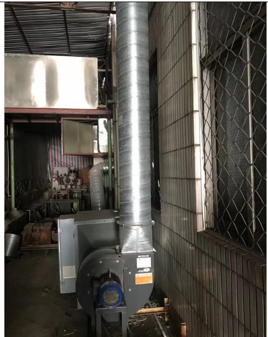
二厂房 1FUV 光解处理
