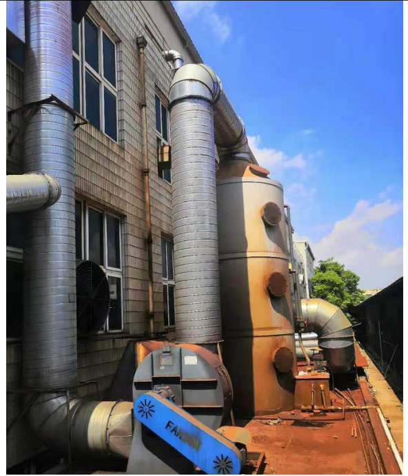
一厂房 1F 机加工喷淋塔
