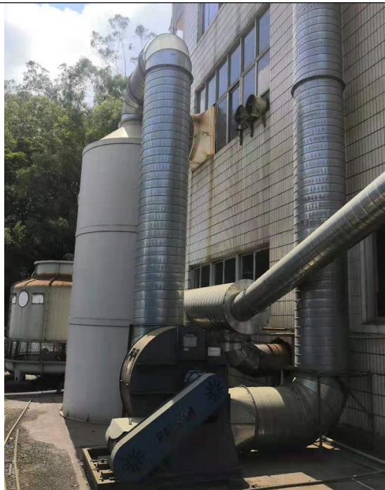
一厂房 2F 喷淋塔
