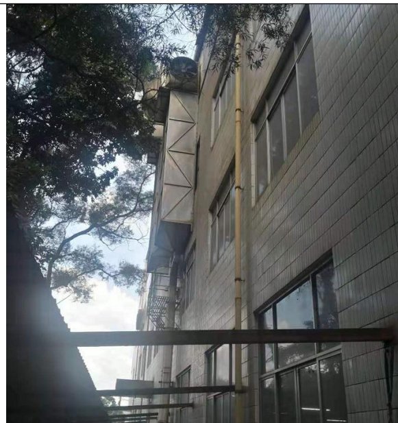
抛丸废气处理排气筒
