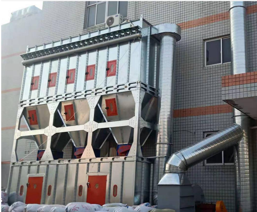
布袋除尘器+15m 高排气筒
