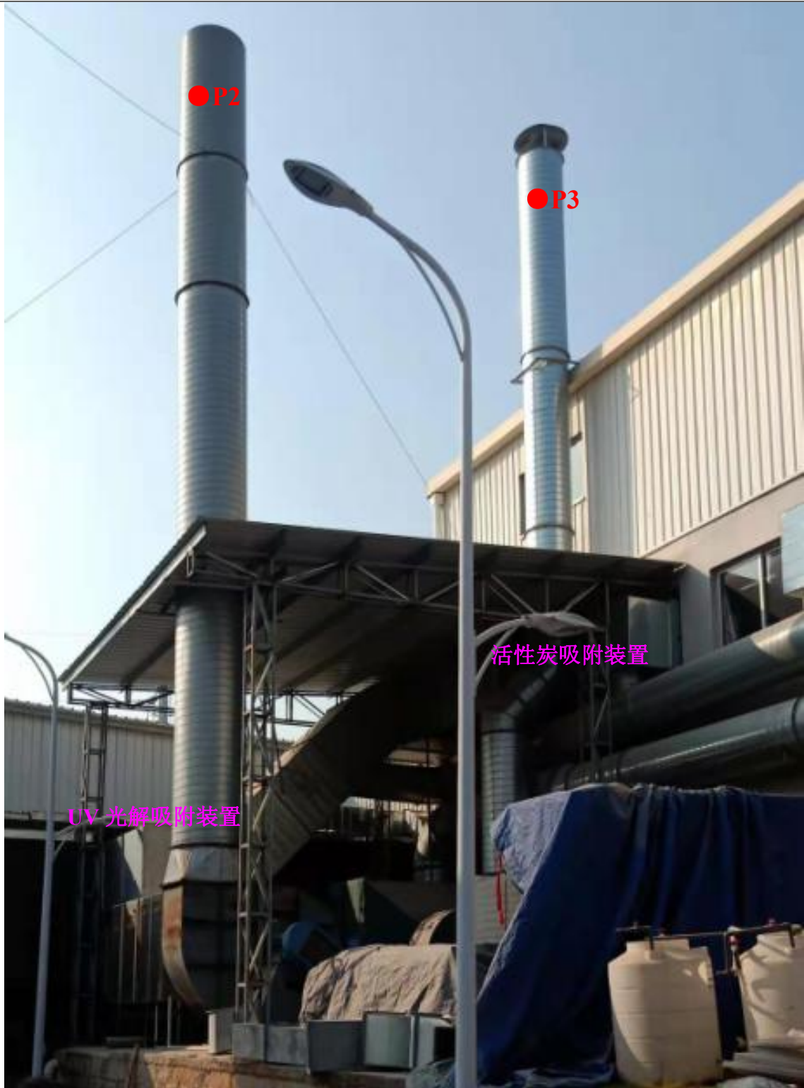
UV 光解吸附装置+15m 高排气筒排放
