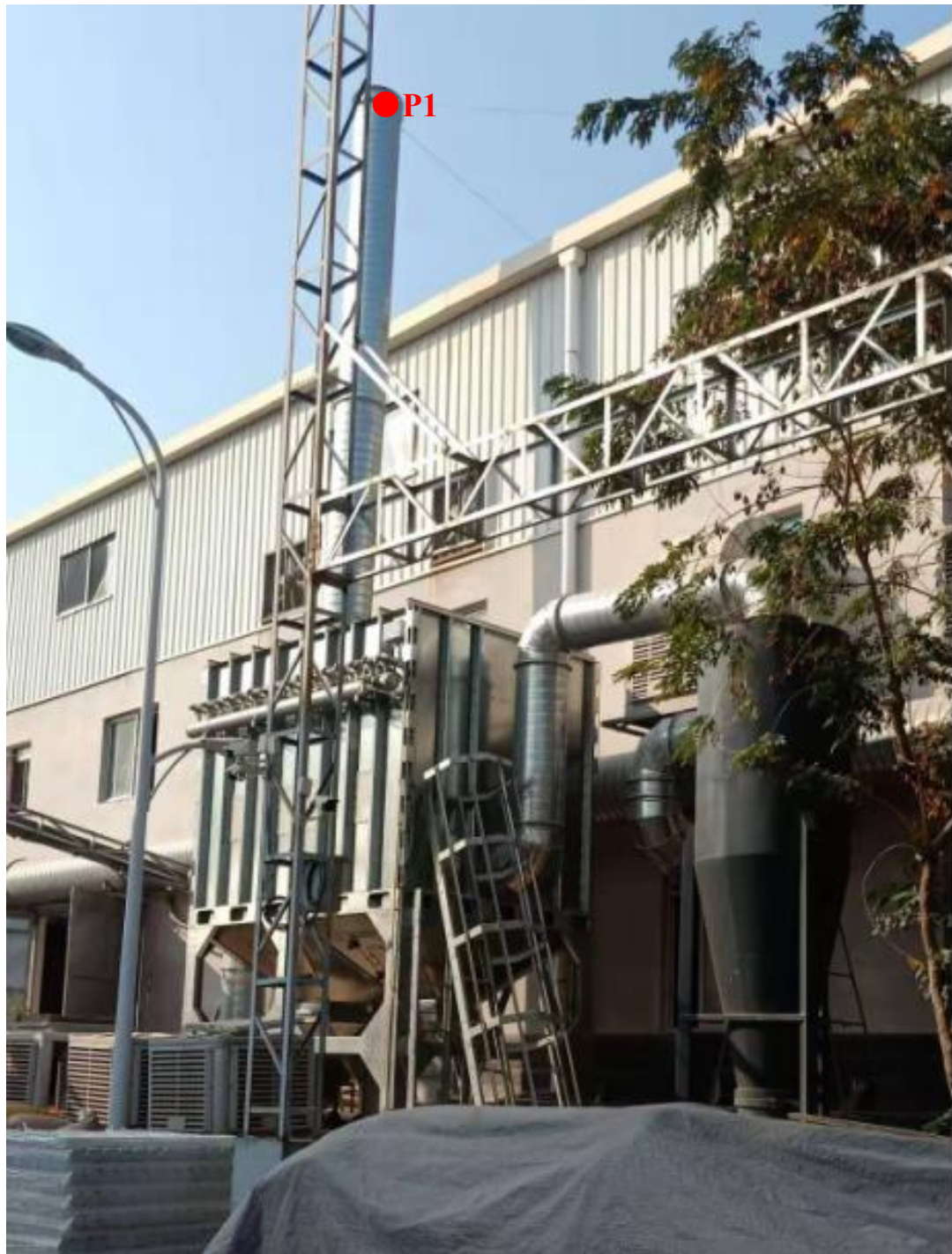
旋风除尘+脉冲布袋除尘器+15m 高排气筒排放
