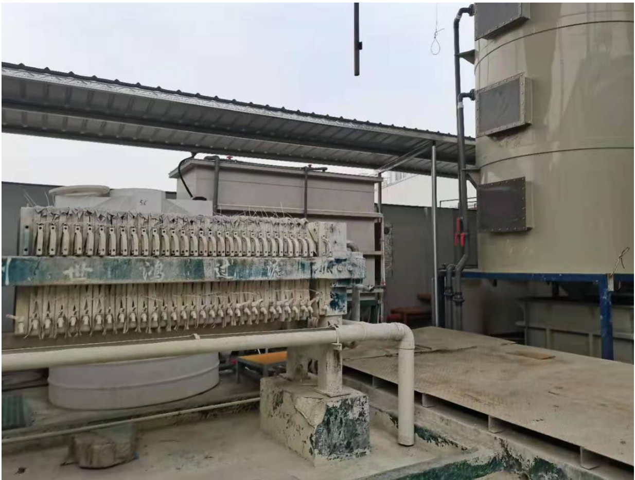
图 3-1 项目废水处理设施（物化处理设施）
