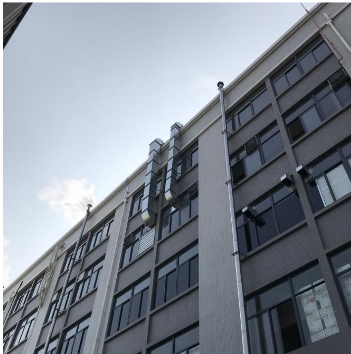
图 3-2 燃气废气排气筒
