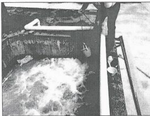
污水处理设施进口
